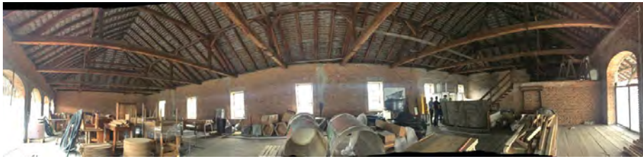
Das beeindruckende Obergeschoß mit seinen 600 m 2 Fläche soll im Industrieambiente bestehen bleiben.
